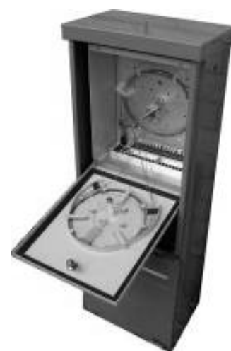
Figur: Exempel på Spridningspunkt (FOS) i markskåp
